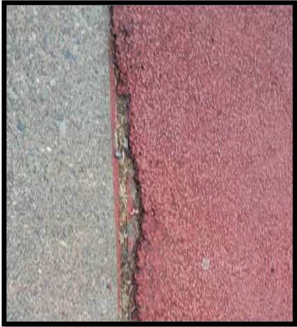
TRACK EDGE DELAMINATING
